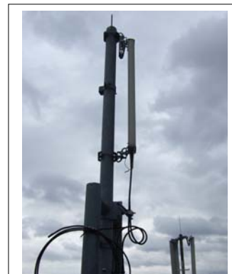
Mobilfunkantenne Bild: Guyot
