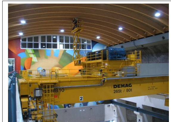
Bild: Brückenkran in einem Wasserkraftwerk. Sowohl die Krananlage, als auch die auf ihr montierte Hubarbeitsbühne fallen unter den Anwendungsbereich der Maschinen-Richtlinie und stellen im Sinne der Richtlinie eine Gesamtheit von Maschinen dar.
